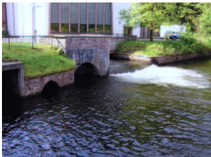
Auslauf Turbine/Turbinenhaus, Rohwasser - Romkerhall
