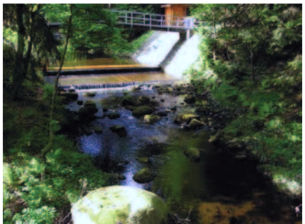
Pegel Unterwasserbecken Auslauf Unterwasserbecken
